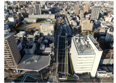
(都)はりまや町一宮線防災・安全交付金工事 (高知県高知土木事務所)
